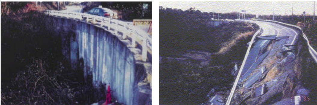
Şekil 3. Miki City’de bulunan duvarın ve yakınındaki yolun deprem sonrası durumu
