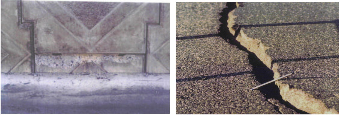
Şekil 2. Lyon Ave’de duvarların en alt sıra panellerinde hasar görünümü ve duvara yakın bir yoldaki yüzey çatlakları
